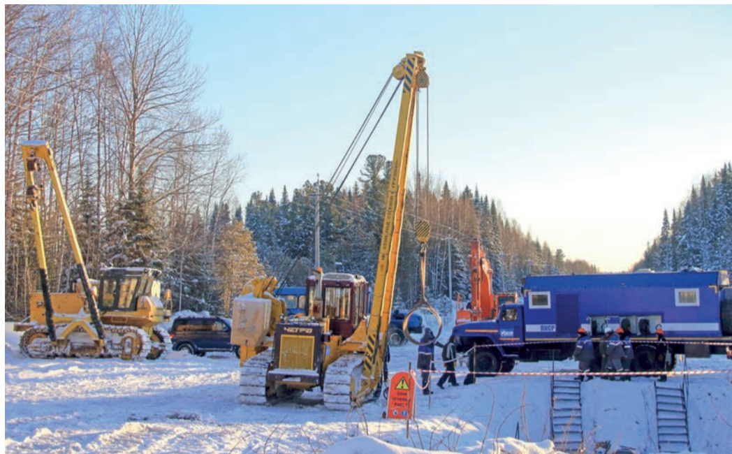
Масштабный комплекс огневых работ проходит на первой нитке магистрального газопровода Нижневартовский ГПЗ – Парабель
