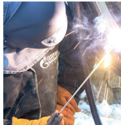
Один из дефектов специалисты устранили методом вырезки катушки за три дня
